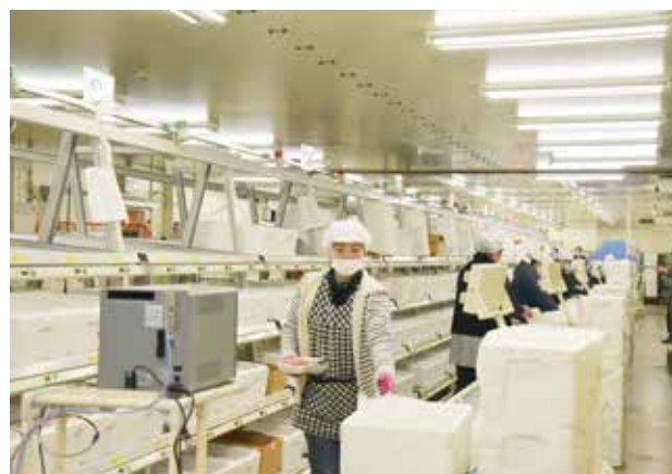
新しい冷凍冷蔵設備の様子
