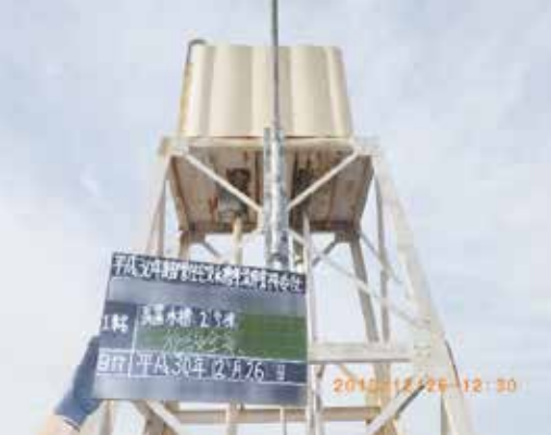
屋上にある高置水槽
